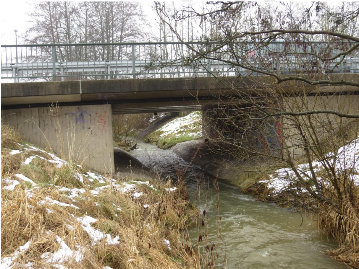
Abb. 30: Brücke mit breitem Betonbankett, das vom Fischotter ( Lutra lutra ) zur Unterquerung trockenen Fußes genutzt wird, am Schmalnohebach bei Sorghof (Kreuzungsbauwerk 3).
